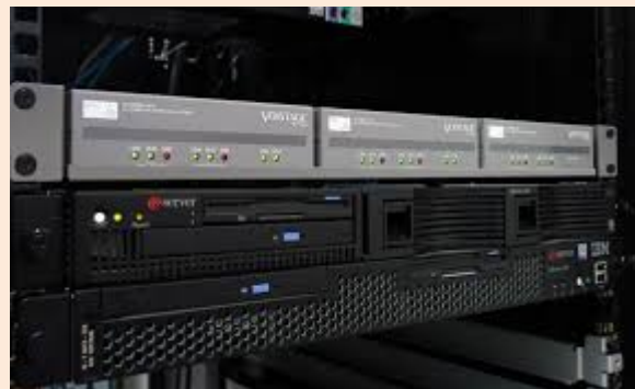
システム全体を制御するサーバー群
